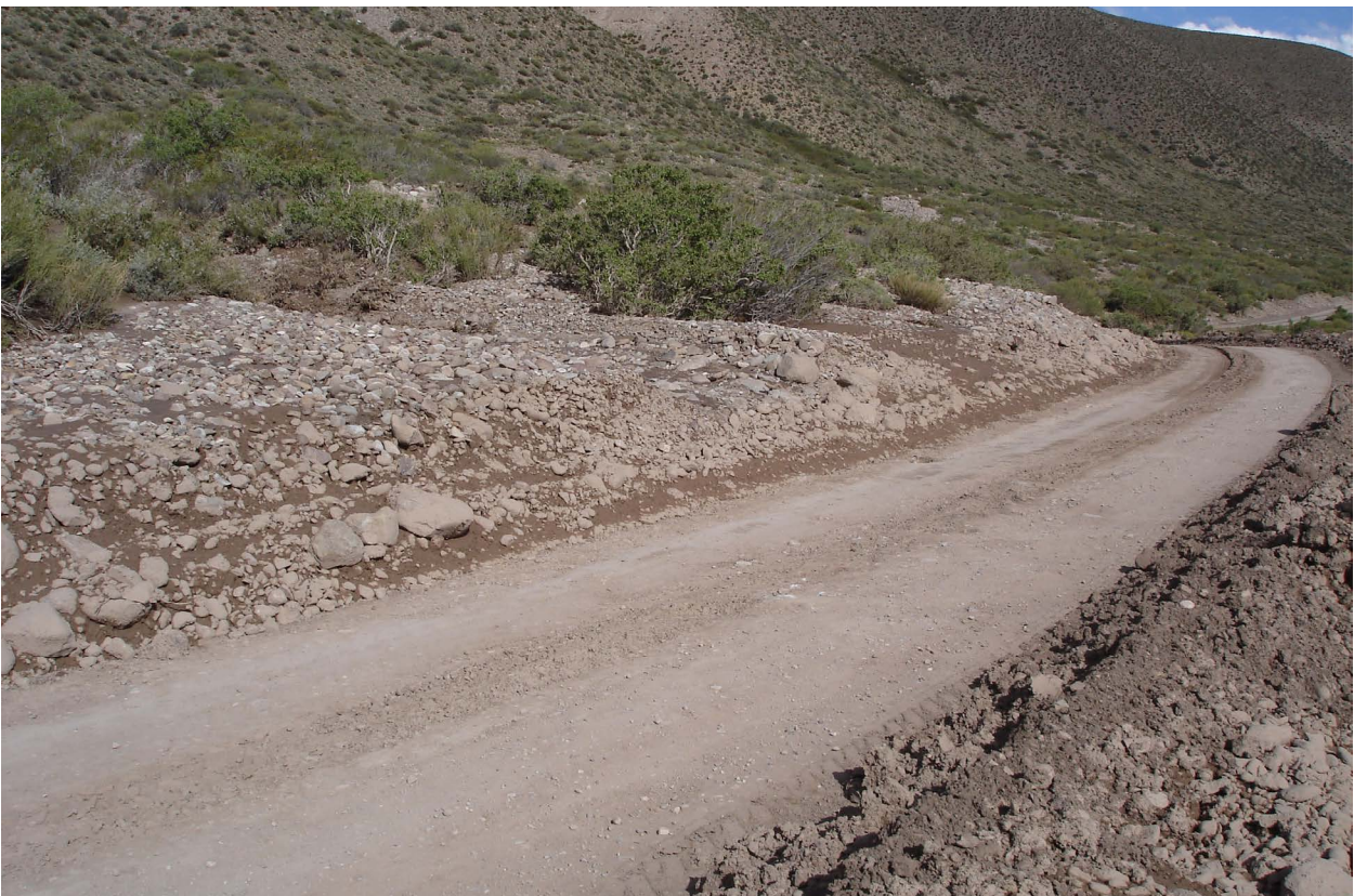
Figura 40. Flujos de detritos originados a partir de las fuertes lluvias torrenciales ocurridas durante la época estival y su incidencia sobre la traza de la ruta provincial 220.
