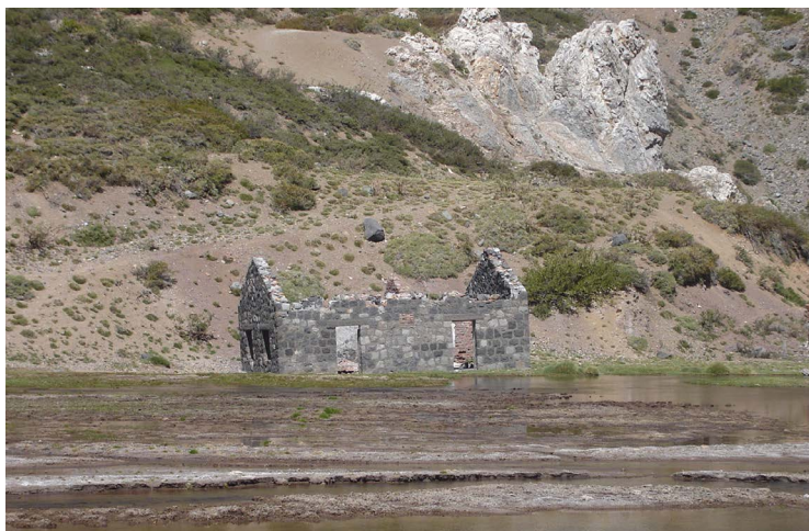
Figura 53. Anegamiento sobre la planicie aluvial del río Atuel ocurrido en las antiguas instalaciones de la ex refinera de azufre Sominar. La disolución del yeso en el sustrato provoca hundimientos en las construcciones.
