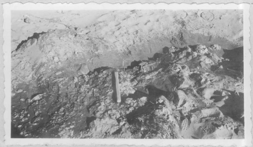
Foto n° 4.- La misma fractura, a la altura del eje del dique proyectado.
