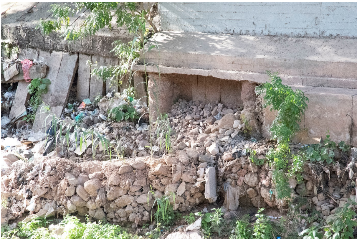
Figura N° 11: Detalle zapata izquierda del Puente Limitrofe S. Mazza - Yacuiba
