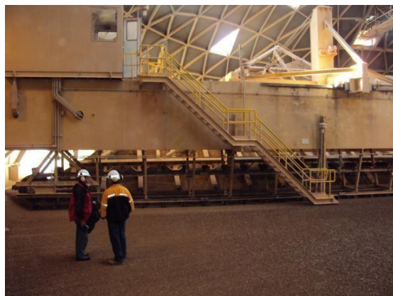
Vista interior del sistema de Apilamiento
