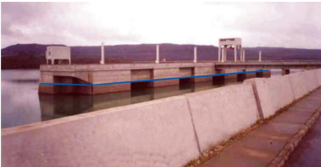
Foto N°21: Vista del nivel actual del embalse y el nivel histórico máximo ( — ), diferencia que permitiría receptor importantes volúmenes durante la época de los deshielos.
