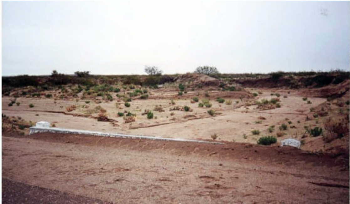
Foto N°16: Flujo denso que en época de lluvias puede cubrir la alcantarilla y cortar la ruta provincial N°6. Al norte de el Cerrito de la Cruz.
