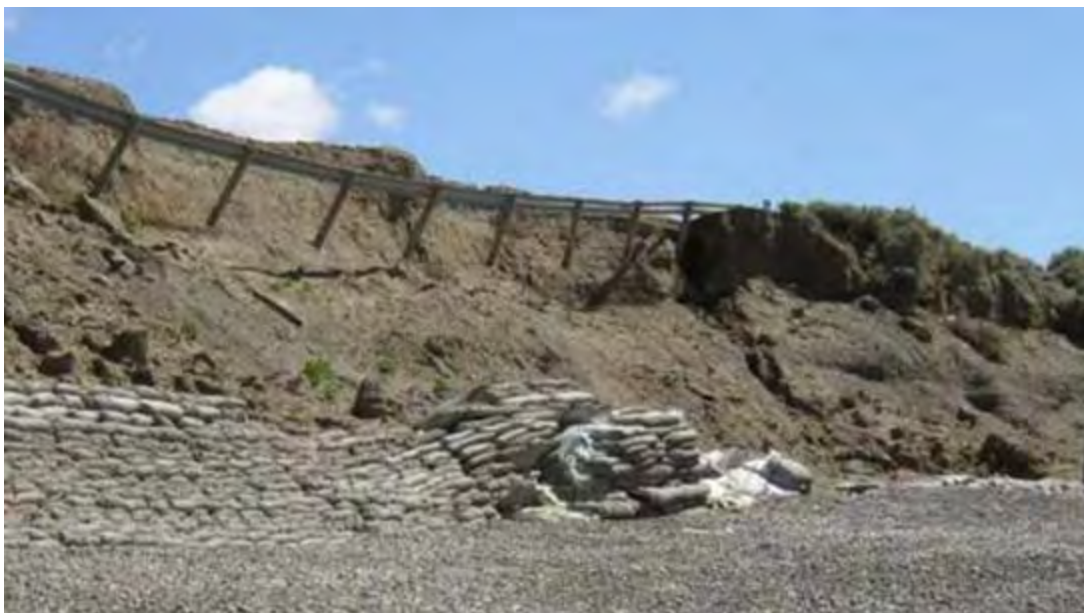
Figura 86: Desmoronamiento del guarda raid en la Ruta Nacional N° 3
