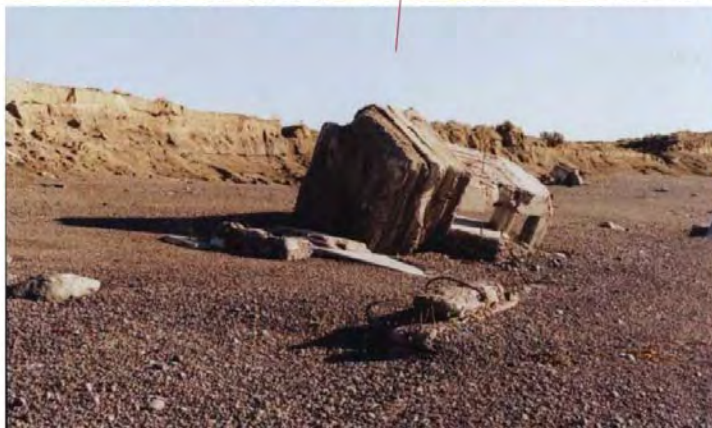
Foto 5: Vestigios del desmoronamiento de un fragmento de la estructura de la Lobería por los efectos recurrentes de la erosión marina a través del tiempo.
