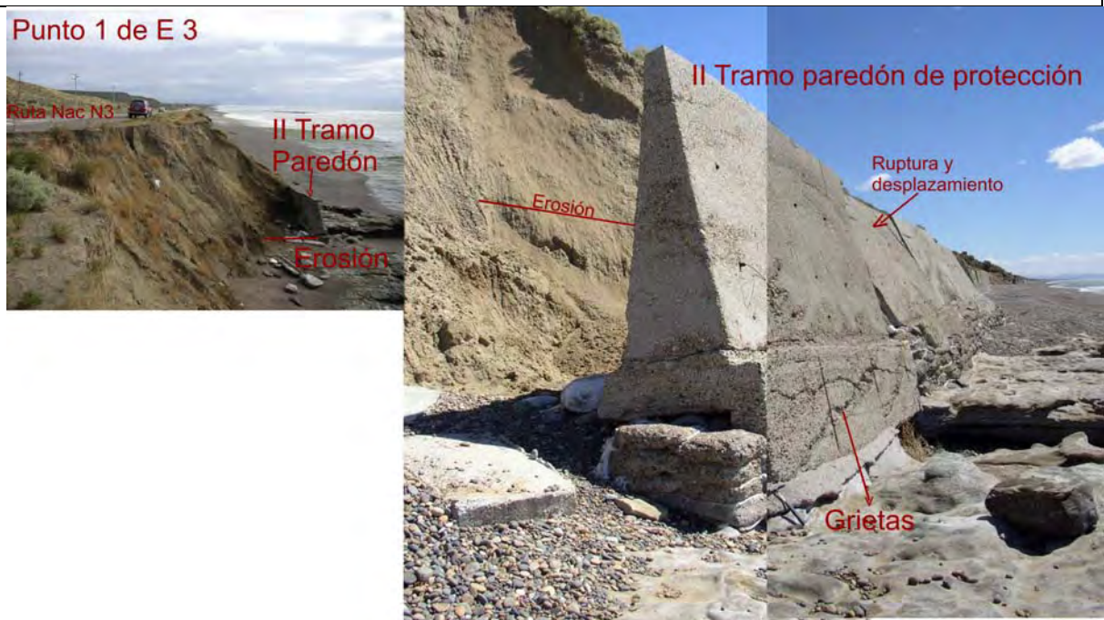
Foto 7: Distintos efectos en el segundo tramo del muro de protección marina en el punto 1 del sector E 3.
