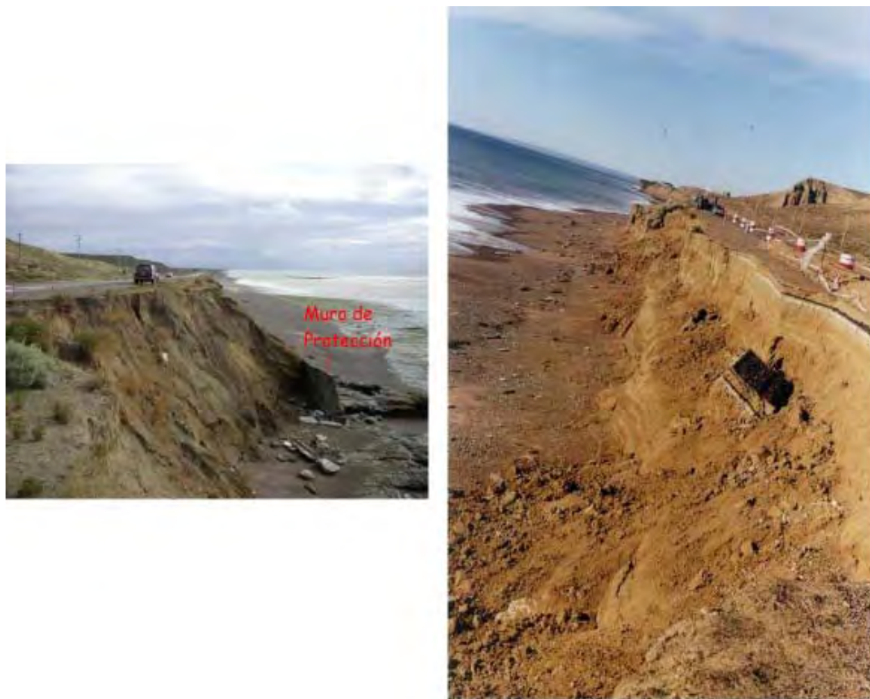
Figura 87: Efectos de la erosión Marina en la Ruta Nacional N° 3, aproximadamente a 2 kilómetros al norte de la Ciudad de Caleta Olivia
