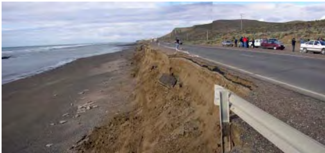
Figura 64: Ruta 3 acceso a Caleta afectada por procesos de remoción y erosión marina
