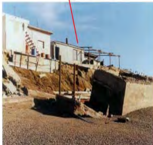
Figura 89: Erosión marina y procesos de remoción en masa asociados, afectando los cordones litorales y el desmoronamiento de los cimientos del establecimiento La Lobería
