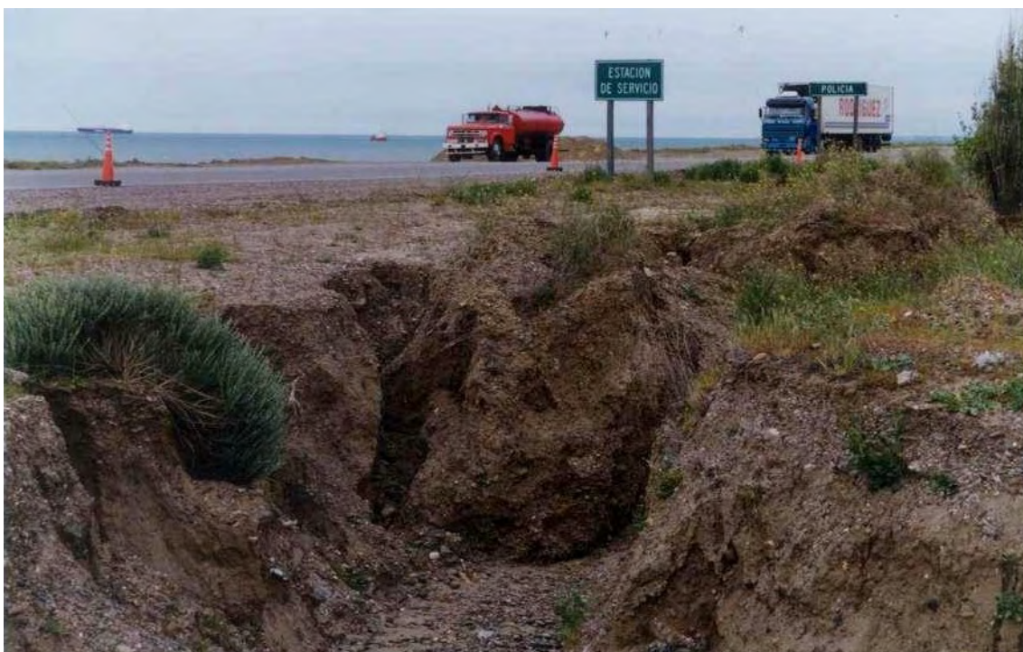
Foto 3: Detalle del punto 2 de la cárcava en el talud de la ruta nacional 3
