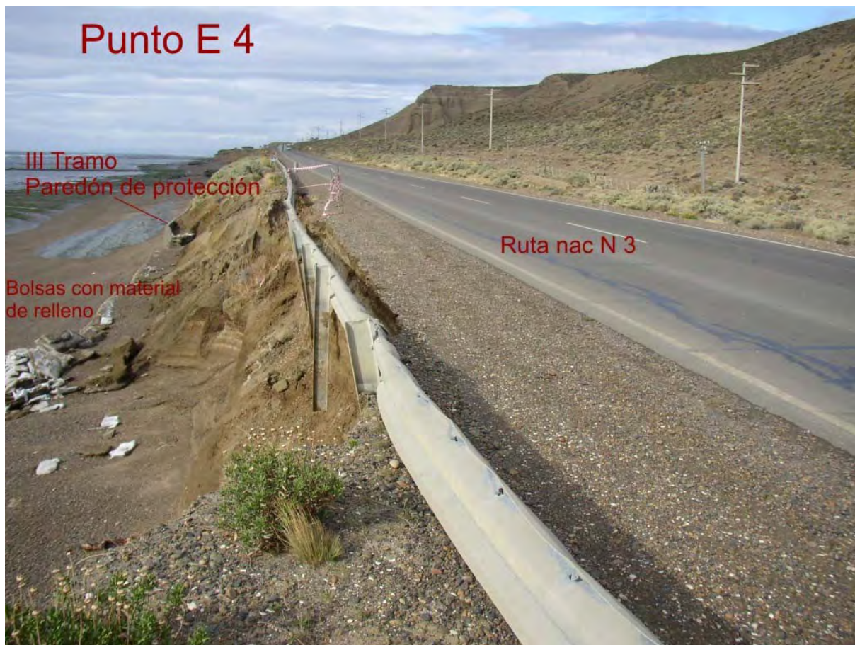
Foto 4: Detalle del punto E4, donde se observa el descalce de guarda raid de la ruta Nac. N° 3 por los efectos de la erosión marina.
