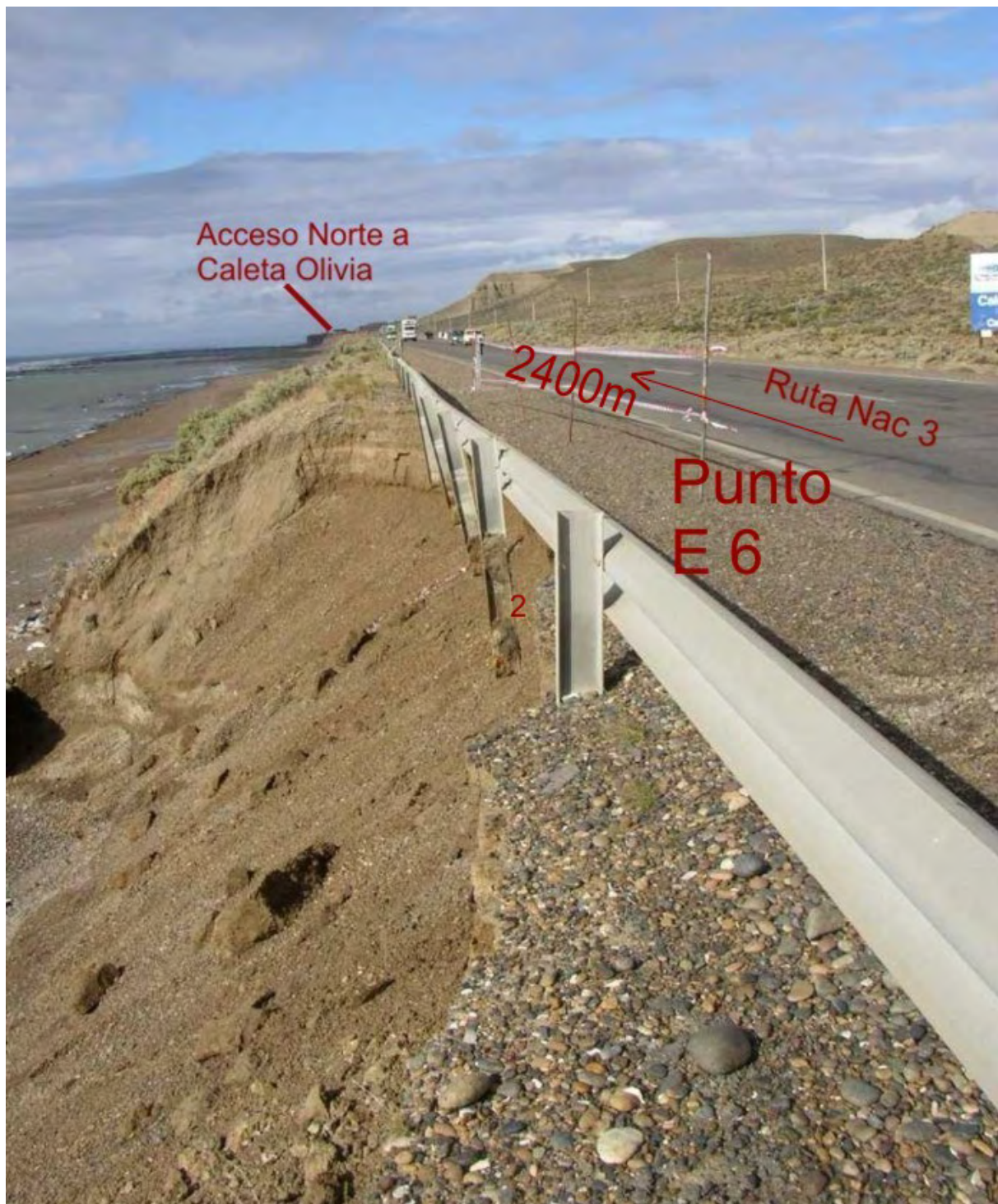
Foto 4: Erosión de la banquina de la ruta nacional N ° 3 por efectos de la marejada del 22 al 24 de abril de 2003. (Pto E 6 a 2400m del acceso norte de la Ciudad de Caleta Olivia).
