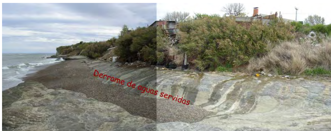
Foto 3: Detalle del punto A donde se observan procesos de erosión marina, de remoción en masa y carcavamiento, potenciado por la infiltración de aguas servidas.
