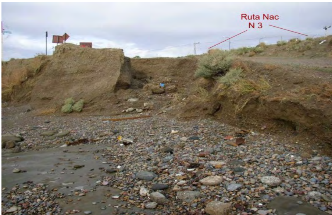
Foto 4: Erosión marina con procesos asociados de remoción en masa y carcavamiento en los acantilados labrados sobre depósitos de cordones litorales y material de relleno. (Pto2)
