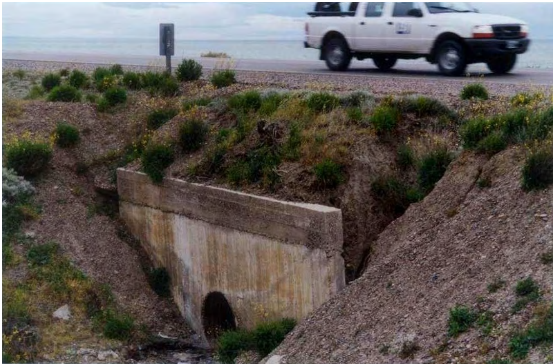
Foto 2: Detalle del punto 1 de la cárcava en el talud de la ruta nacional 3
