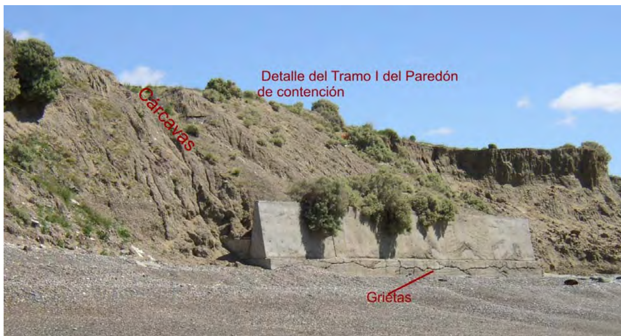
Foto 6: Detalle del primer tramo del muro de protección con procesos de erosión marina y procesos asociados de remoción en masa y erosión hídrica (cárcavas).
