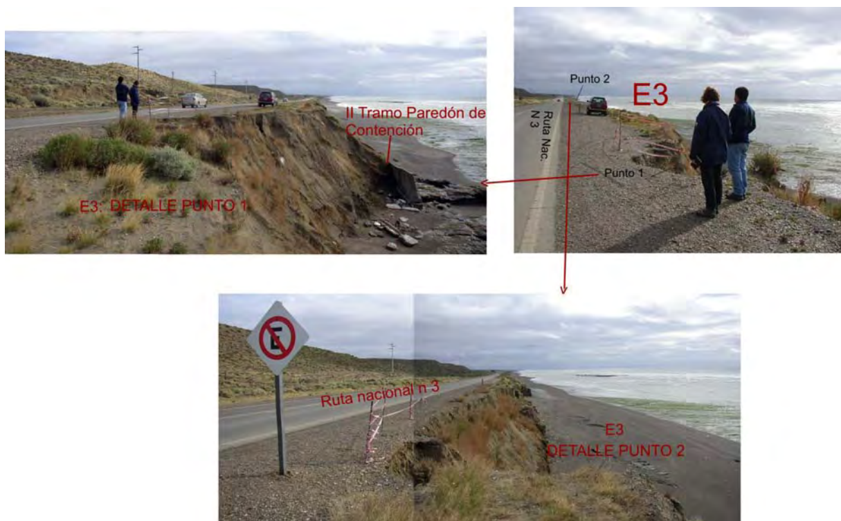
Foto 2: Efectos de la erosión marina en E3 aproximadamente a 1000m a 1200 metros de la Estación de Servicio en el acceso norte a la ciudad de Caleta Olivia.
