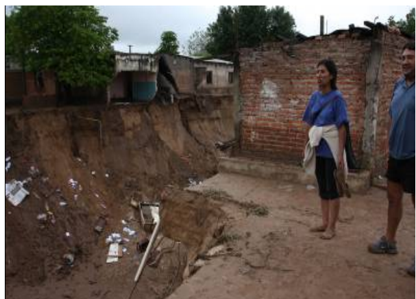
Figura 53: Vista del cauce del río Tartagal aguas abajo del puente de la avenida Packham donde se observa el retroceso de las barrancas por erosión y deslizamientos (vuelcos) y destrucción de las casas ubicadas a orilla del río.
