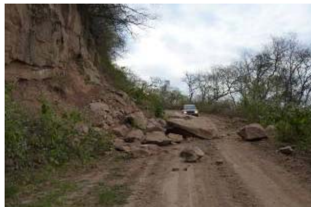
Figura 66: Caída de roca a partir de un afloramiento de areniscas poco consolidadas del terciario subandino, en el camino que va a la planta de Tecpetrol Chango norte.
