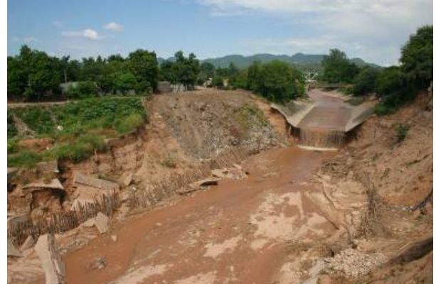
Figura 48: Vista del río Tartagal hacia la sierra, evento del 2006, destrucción del revestimiento del río, profundización y erosión de las barrancas (Foto municipalidad de Tartagal) .
