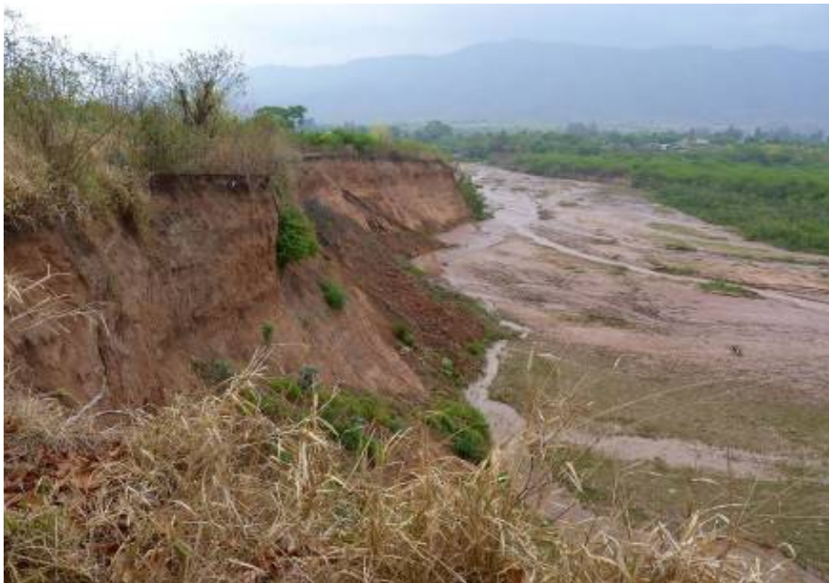
Figura 84: Vista de las barrancas de la quebrada de Yacuiba desde la Misión El Obrero. Las barrancas en los últimos años (2006 a 2009) retrocedieron más de 6 m. Las viviendas y la escuela ubicadas en las proximidades de la barranca tuvieron que ser trasladados.
