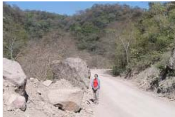
Figura 65: Se observan grandes bloques al costado de la ruta provincial 46 que va a Acambuco. Los bloques se desprenden del afloramiento de bancos de areniscas competentes de edad Carbonífera.
