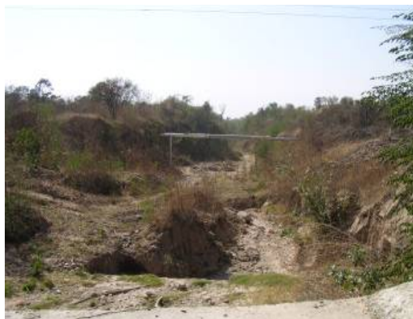
Figura 64: Profundización del cauce en el arroyo Tranquitas, aguas abajo de la ruta Nacional 34. Obsérvese atrás, el gasoducto que cruza el cauce.
