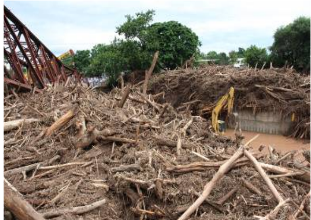
Figura 52: Vista de los troncos que se acumularon antes del puente de la avenida Packham y que generaron el endicamiento y el desplazamiento del puente del ferrocarril.
