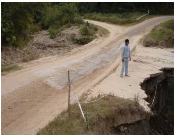
Figura 62: Erosión retrocedente y rotura del puente en el arroyo Gritón.
