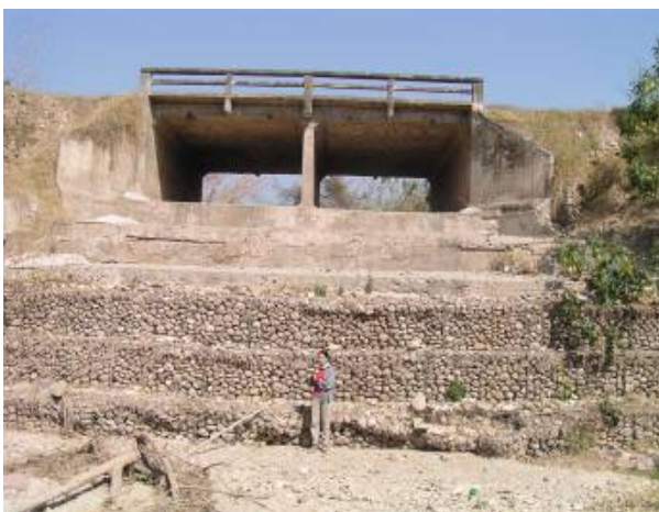
Figura 63: Arroyo Tranquitas erosión retrocedente, se observa la profundización del arroyo y los gaviones que se construyeron para evitar que se descalza el puente.
