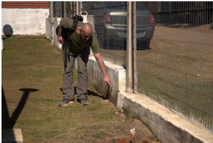
Figura N° 15: Marca dejada por el agua durante inundaciones de los últimos años
