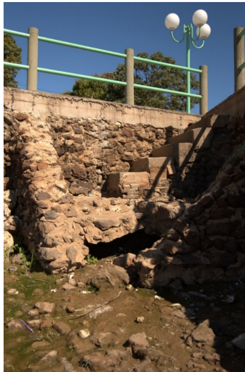
Figura N° 12: Defensa costera a la altura del predio de Aduana y Migraciones. Existe una incipiente erosión en la base de algunos sectores de la estructura, por lo que se recomienda su reparación
