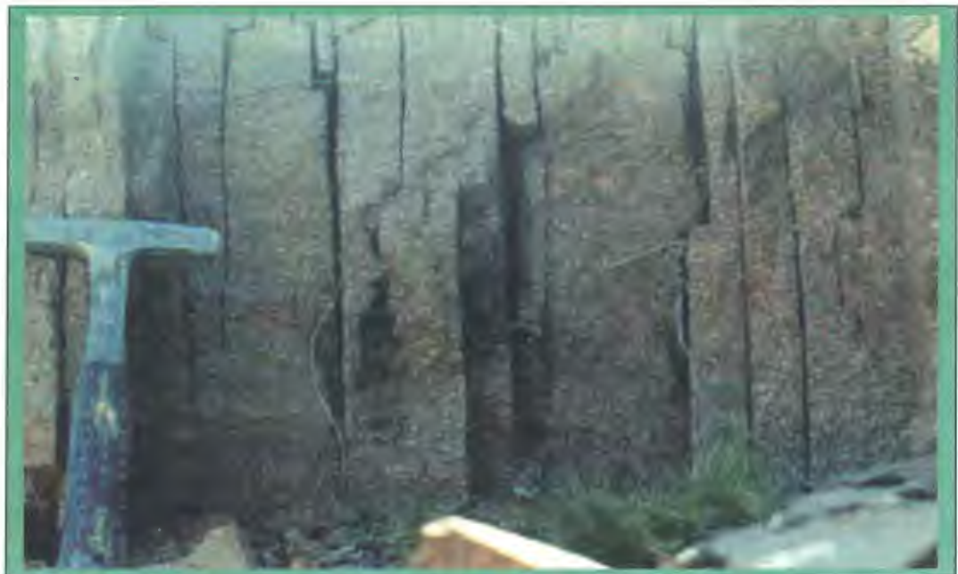
Detalle del lajamiento en frente de cantera– Cantera de Perdomo
